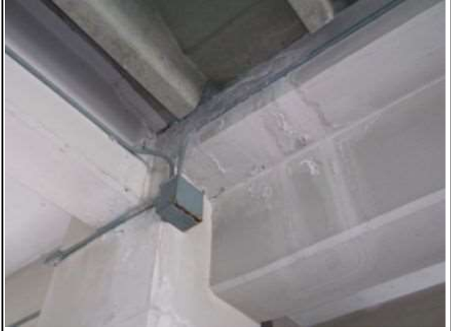
凝集沈殿槽 プレキャスト天井面漏水跡
