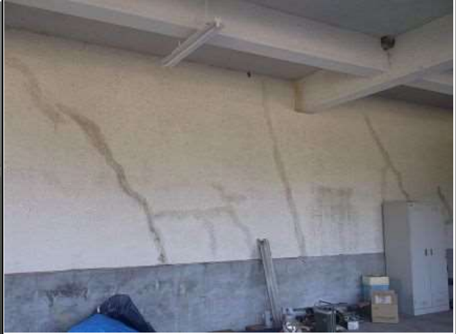
投入後室階下部分 クラック跡
