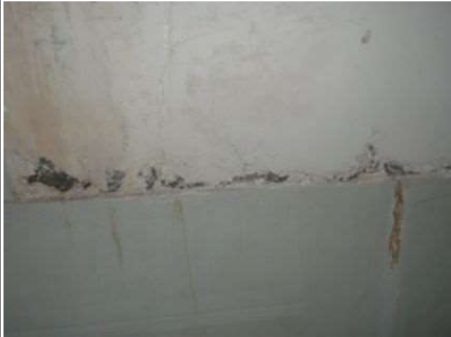
第二曝気槽外壁 クラック跡
