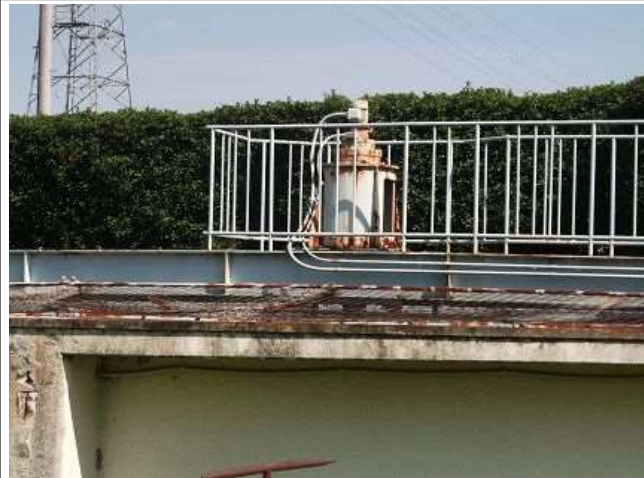
河川水凝集沈殿地 腐食
