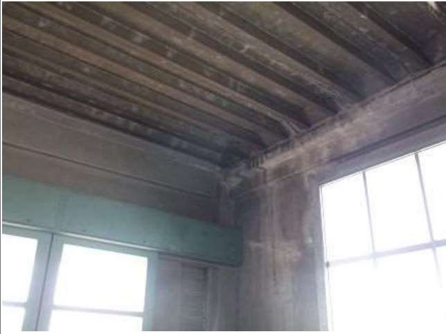
投入前室 プレキャスト天井面漏水跡
