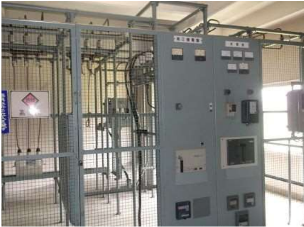
受変電設備 老朽化
