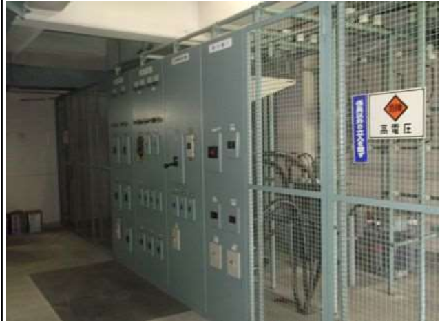
受変電設備 老朽化
